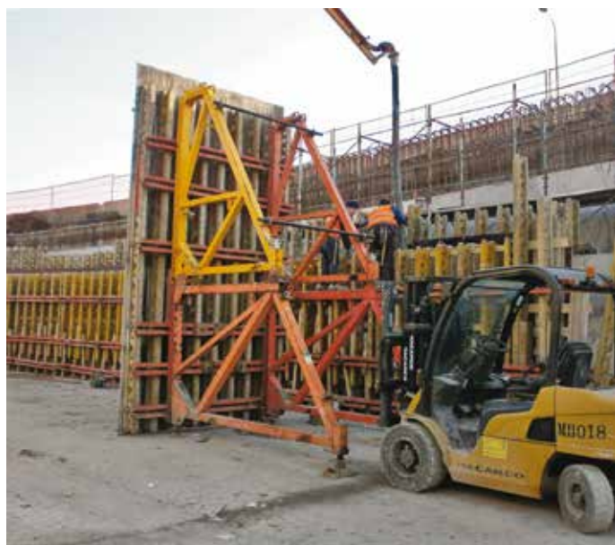
14. Le fasi di costruzione dei gusci in c.a. delle Rampe A e B
